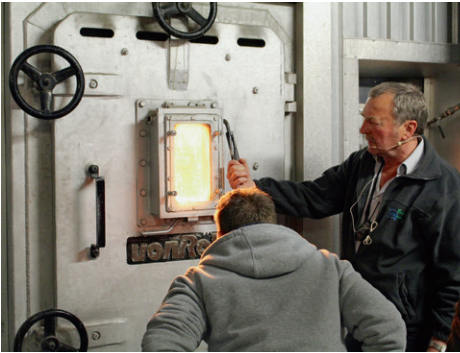
Ein speziell verglastes Fenster erlaubt den Blick in den Verbrennungsofen.
